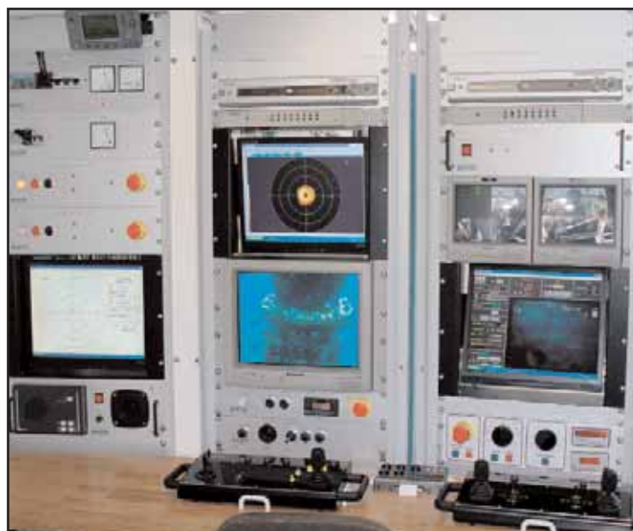
Poste de pilotage
